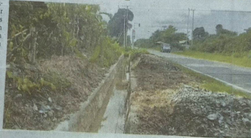
PROYEK: Pengerjaan saluran air (drainase) di Jalan Lintas Trans Kalimantan ini dinilai tak beraturan dan semrawut.
